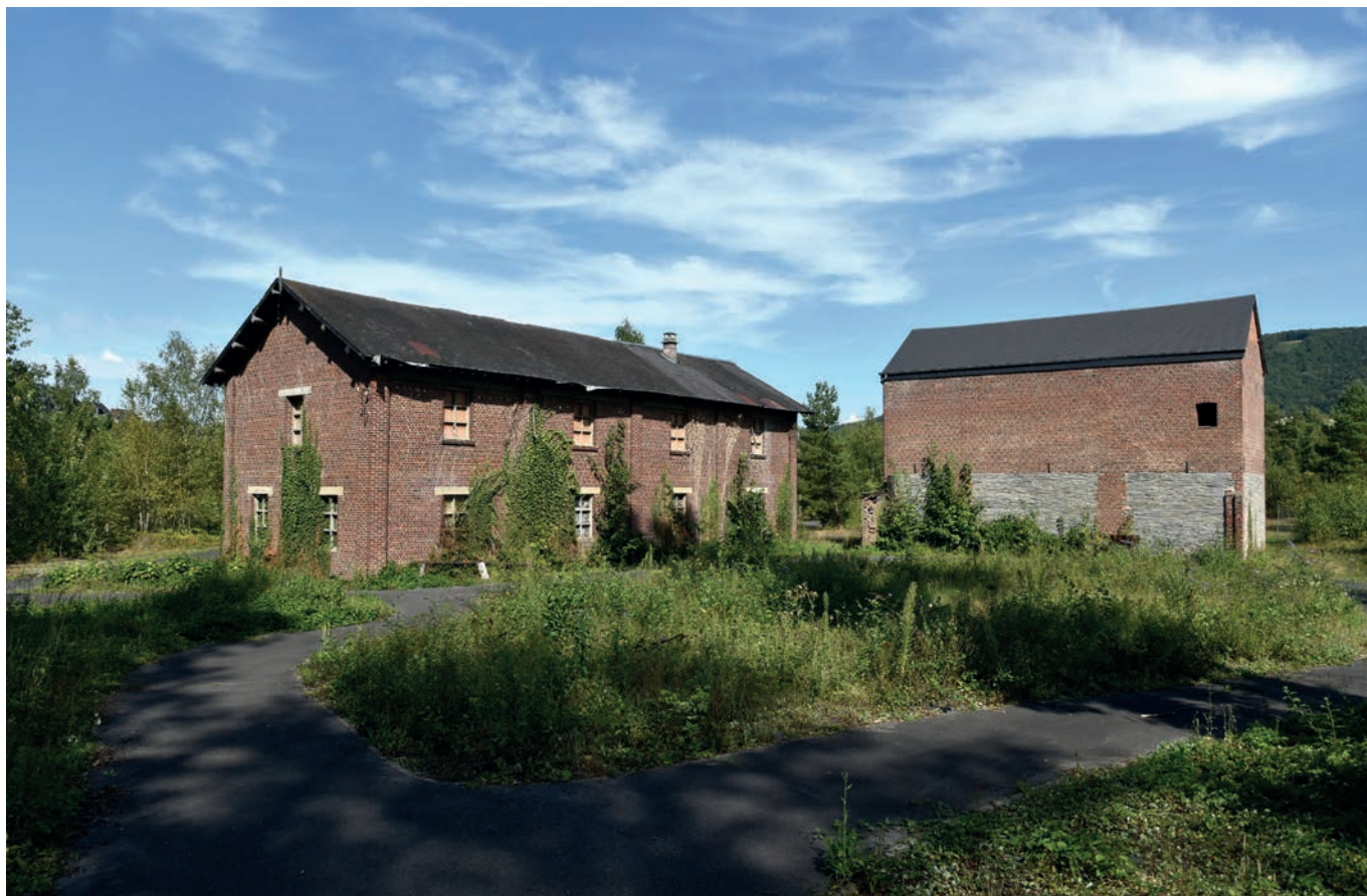
Les bâtiments administratifs des Ardoisières de Saint-Joseph à Fumay, en cours de restauration, sur le site de Terre Altitude. Photo P. Cattelain, Écomusée du Viroin, août 2016.
