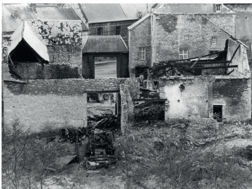
Fig. 9. La grange de la Ferme-Château après l'incendie de 1979, vue du nord. Photo © Roland Collard.
