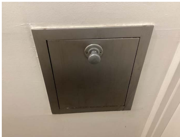
Trash chute door
