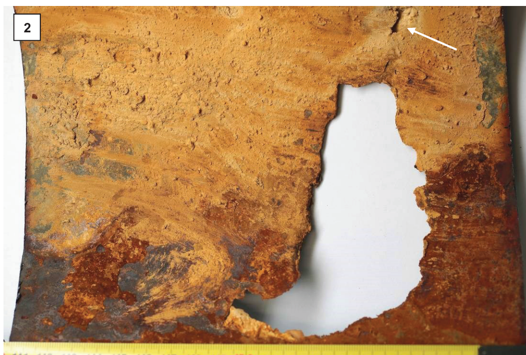
Figuur 14. Het binnenoppervlak rond het grotere lek had een soortgelijk karakter als dat bij het kleinere lek. Op de 6 uur positie was nog een secundair lek zichtbaar (zie witte pijl) van ~ 11 x 10 mm, dat aan de buitenzijde vrijwel niet zichtbaar was vanwege de nog grotendeels intacte coating op die positie. Vanuit de hoek van het grotere lek liep een scheurvormige uitloper met een lengte van ~ 11 mm richting het secundaire lek.
