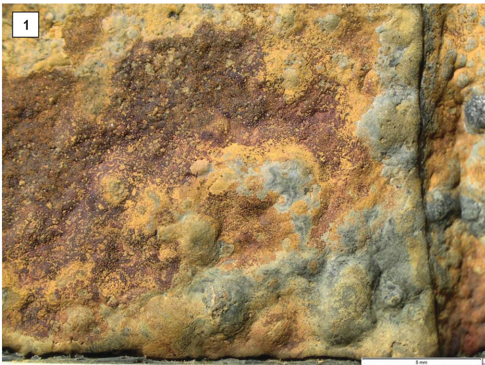
Figuur 8. Aan de bochtzijde toonde het binnenoppervlak een iets golvend karakter met ondiepe en deels met product gevulde corrosieputten. De doorlassing stak ~ 2,3 mm uit ten opzichte van het oppervlak van de bocht en toonde een soortgelijke aantasting. Over het geheel van de sectie was de aantasting relatief gelijkmatig.
