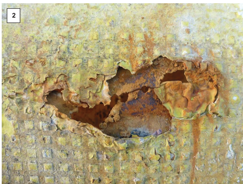
Figuur 4. Het kleinere lek toonde eveneens iets naar buiten krullende dunne randen. De coating bedekte nog een deel van het lek.
