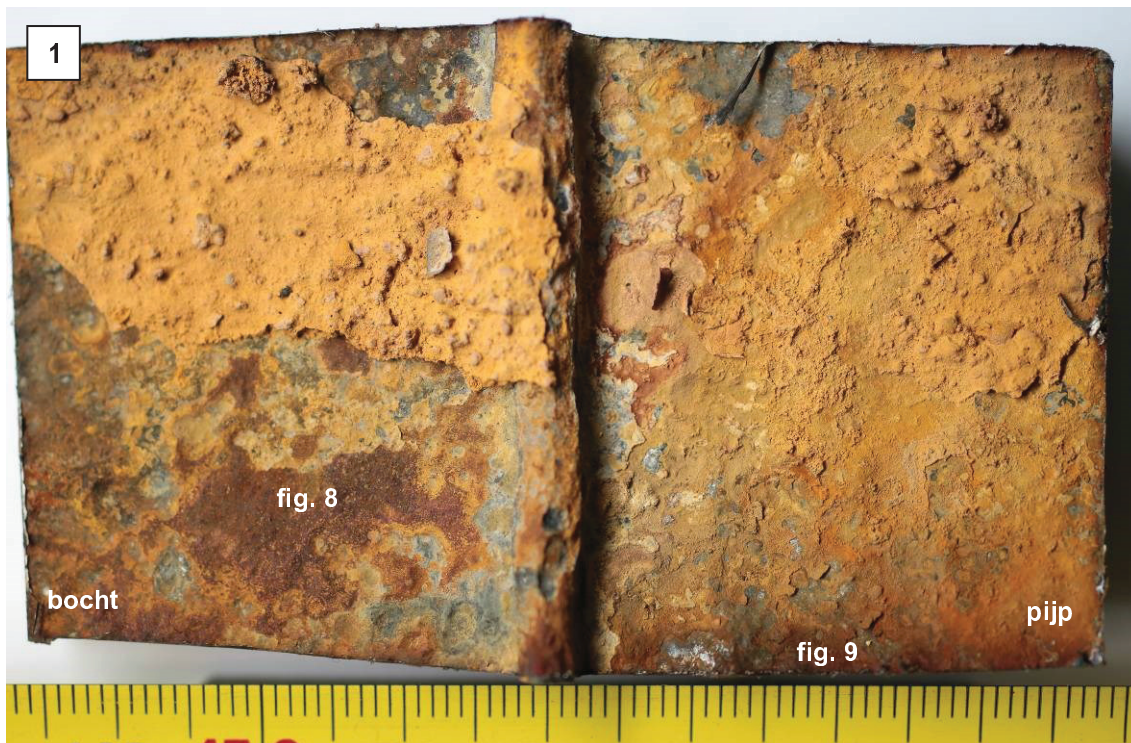
Figuur 7. Het binnenoppervlak van sectie 1 toonde een iets uitstekende doorlassing met aan de pijpzijde een duidelijk dieper terugliggend oppervlak. Wanddiktemetingen inclusief coating gaven aan de bochtzijde een wanddikte van ~ 9,0 mm en aan de pijpzijde een wanddikte van ~ 7,1 mm.
