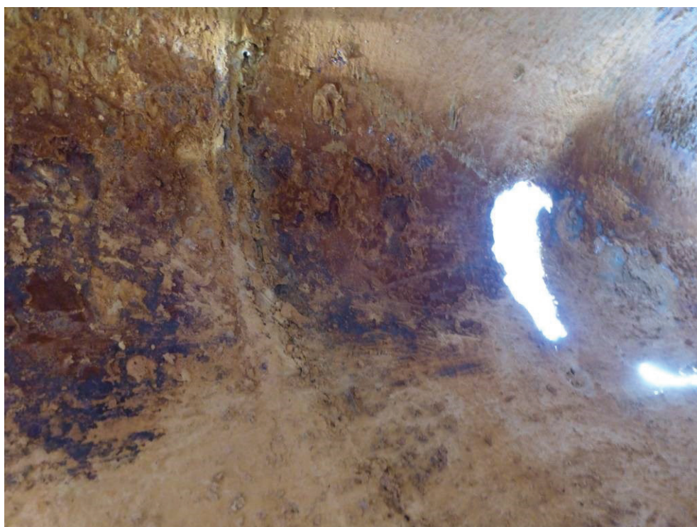
Figuur 6. De binnenzijde van de leiding toonde een lokaal onregelmatig oppervlak met productafzettingen van verschillende dikte en een vlekkerige bruine kleur. De oorspronkelijke onderste helft van de leiding toonde meer en dikkere productafzettingen dan de bovenste helft. Ter plaatse van de lekken was geen sterk afwijkende aantasting zichtbaar. Op de positie van de rondlas was aan de oorspronkelijke onderste helft van de leiding (rondom de 6 uur positie) een wanddikteverschil zichtbaar tussen het dikkere bochtdeel en het pijpdeel. De bovenste helft van de leiding toonde geen duidelijke overgang.
