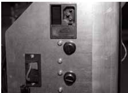
fig. 21 - Termostati di sicurezza
