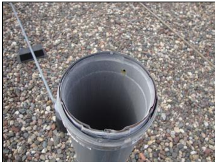
24. Missing rain cap(s)
