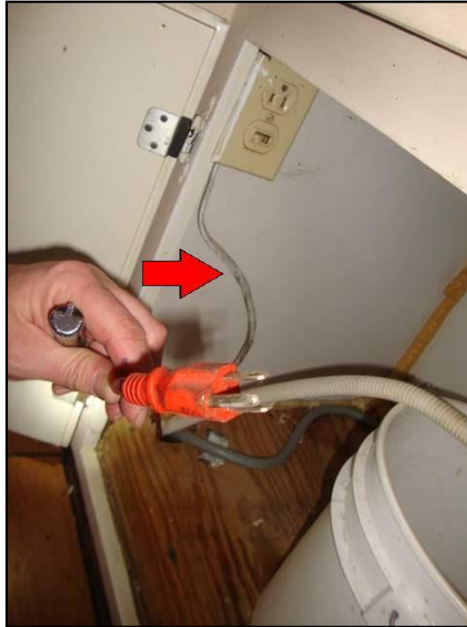
52. Flexible conduit needed
