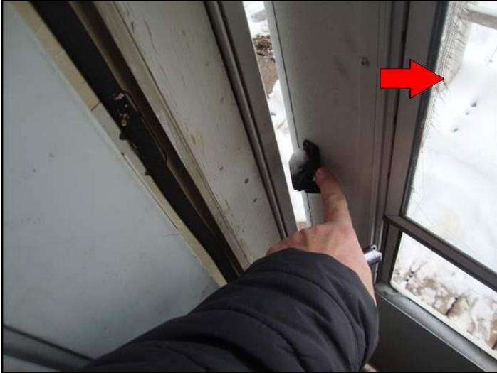
23. Torn or holes
