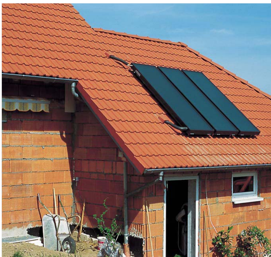
Bild 37: Die Solaranlage liefert bereits im Rohbau nutzbare Wärme
