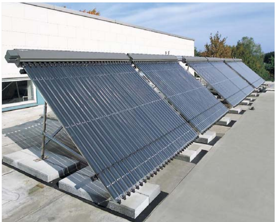
Bild 39: Schule in Siegen-Wenden mit 18 m 2 Vitosol 300 Vakuum-Röhrenkollektoren
