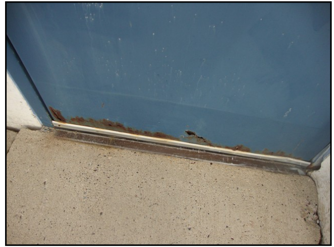
104 : Exterior - Door Rust 2
