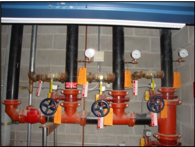
117 : Fire Protection - Risers
