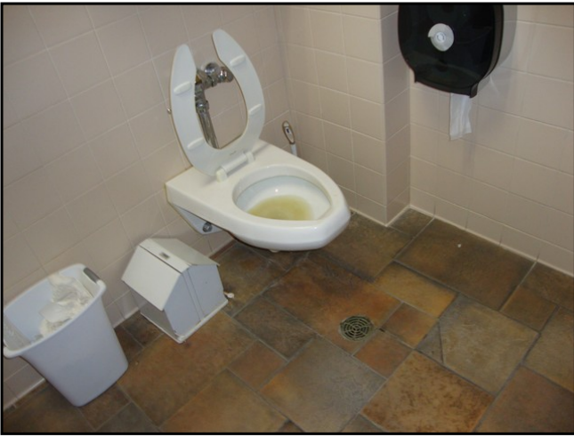
31 : Plumbing - 2355 Lemond RD 280
