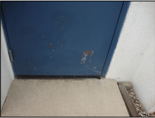
103 : Exterior - Door Rust 1
