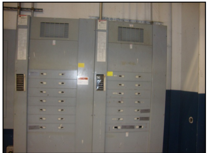
18 : Electrical - Panel Mains
