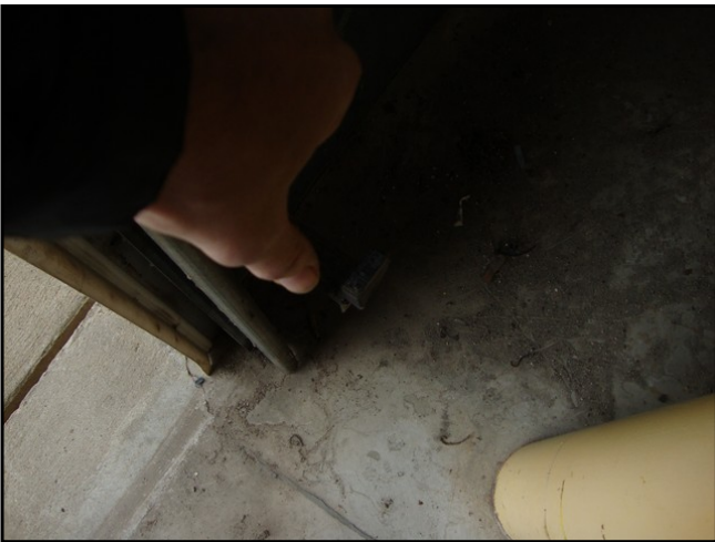
105 : Exterior - Inoperable Auto Reverse @ Door 104
