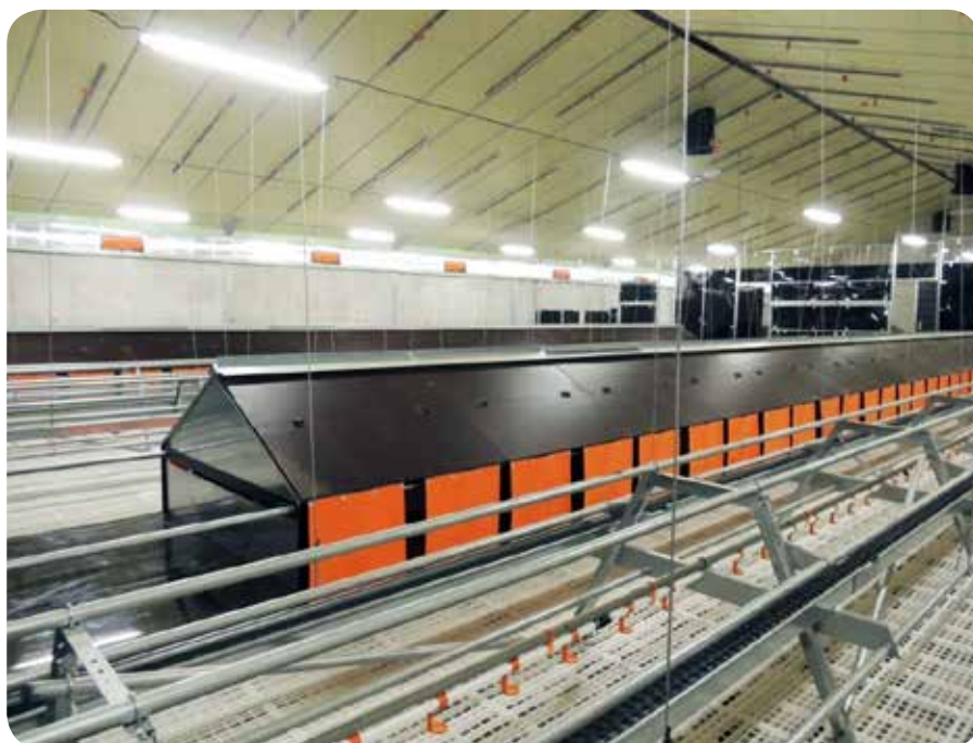
De chaque côté devant les pondoirs, des caillebotis en plastique sont installés sur une fosse. Sur ces caillebotis, sont posés des perchoirs, une ligne d'eau avec pipettes avec coupelles de récupération et une mangeoire linéaire avec chaîne.
