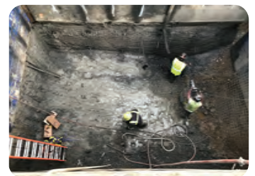
Conduit 16 Highway 58, CO
