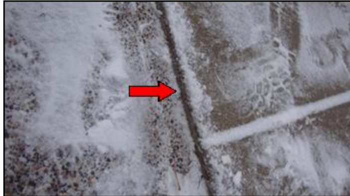
Uneven (trip hazard)
